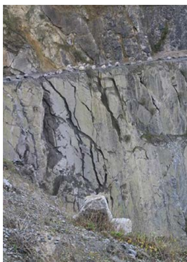
Présence de réseaux karstiques.
